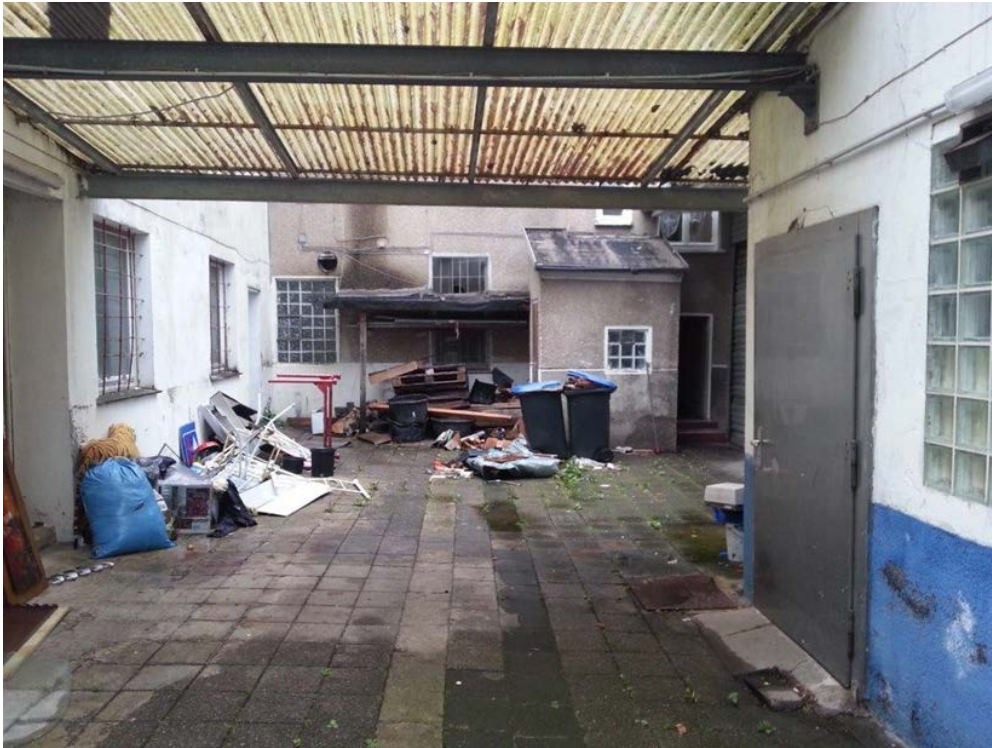
Vermüllung, Leerstände, Instandsetzungsrückstände
